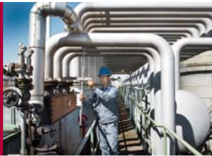
Olipa kyse putkistojen suunnittelusta, asennuksista tai muutostöistä, niin asiakkaalla on mahdollisuus saada kaikki palvelut yhdestä yrityksestä, joka on Voith Industrial Services.
