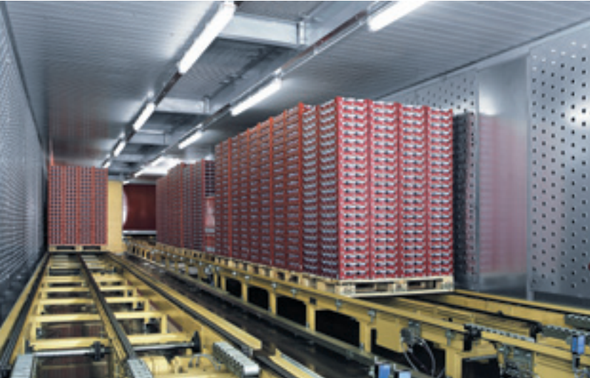
Kaksoistoiminen jäädytystunneli (sisäkuva)
