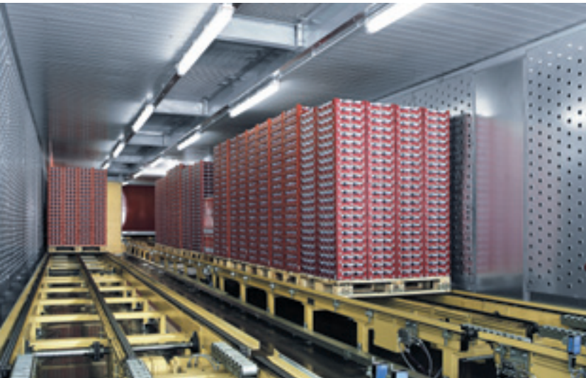
Zweispuriger Kühltunnel (Innenansicht)
