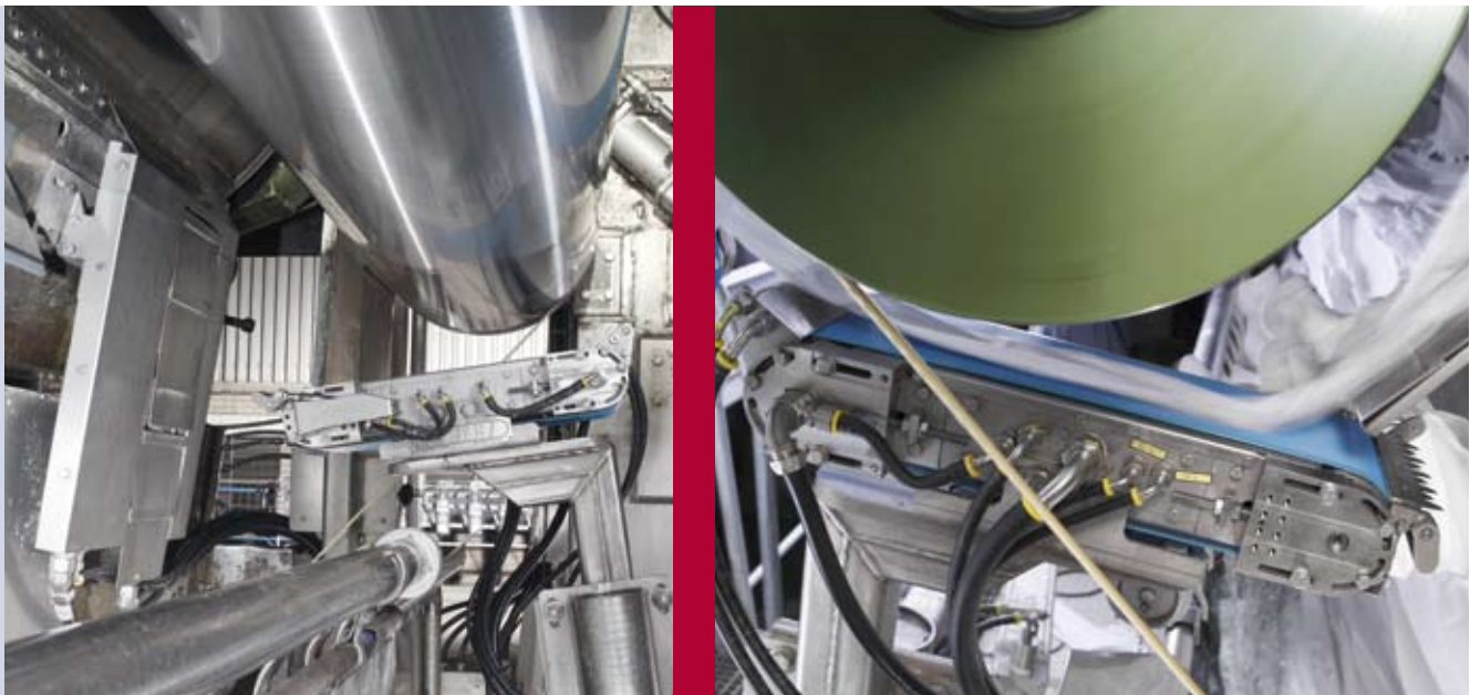
Abb. 4: Prevo-Überföhrlösung an einer PM in der Sektion SpeedSizer (links: Arbeitsposition; rechts: erfolgreicher Treffer).
