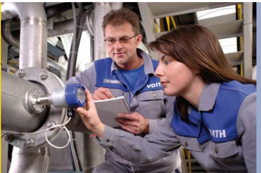
Kenttälaitteen valinta, toimitus, asennus, käyttöönotto sekä valvonta yhden toimijan vastuulla: OnC PressSens painelähettimen toiminnan tarkastus.
