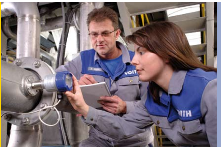
Auswahl, Lieferung, Installation und Kontrolle in einer Hand: Überprüfung des Drucktransmitters OnC PressSens.
