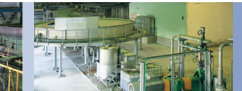
Sama näkymä uusinnan jälkeen uusine jauhimi- neen ja vedenkä- sittelylaitteineen
